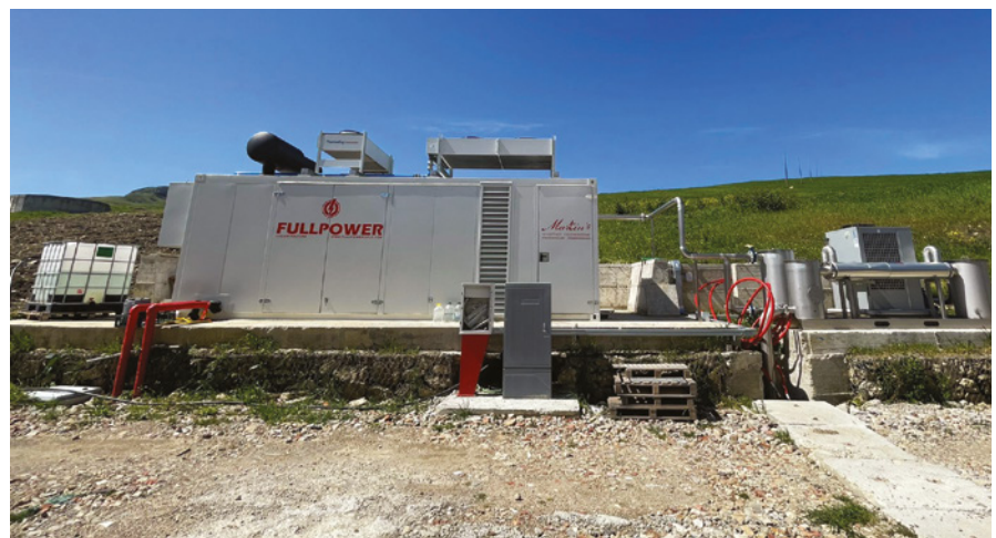
Fig. 13 - Cogeneratore per la produzione dell'energia elettrica e termica tramite biogas presente nell'azienda Agricola Puccia.
