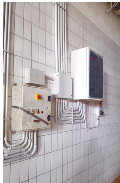
Fig. 9 - Quadro elettrico zona abbattimento bovini dell'azienda Agricola Puccia.
