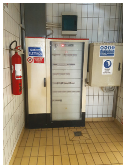
Fig. 8 - Quadro elettrico linea macellazione suini e ovini dell'azienda Agricola Puccia.
